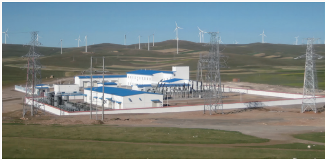
图 3.3 内蒙古乌兰察布新一代电网友好绿色电站示范项目
