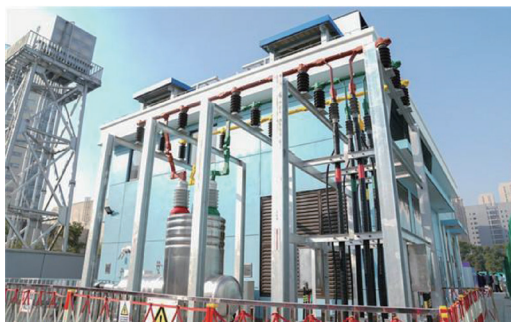
(c) 高温超导电缆并网接线
