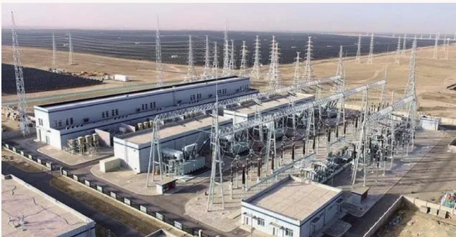
图 3.4 青海海南千万千瓦级新能源基地内的旭明 330 千伏汇集站
